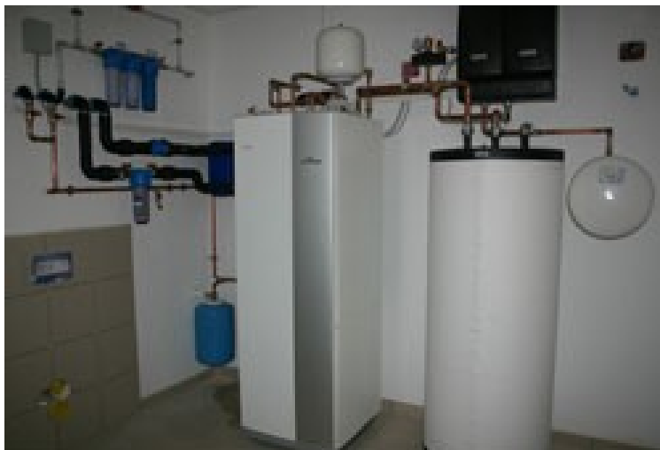
Slika 34: Toplotna črpalka s hranilnikom toplote (Vir: http://knut.si/showpage/158/Referencni_objekti.html ).
